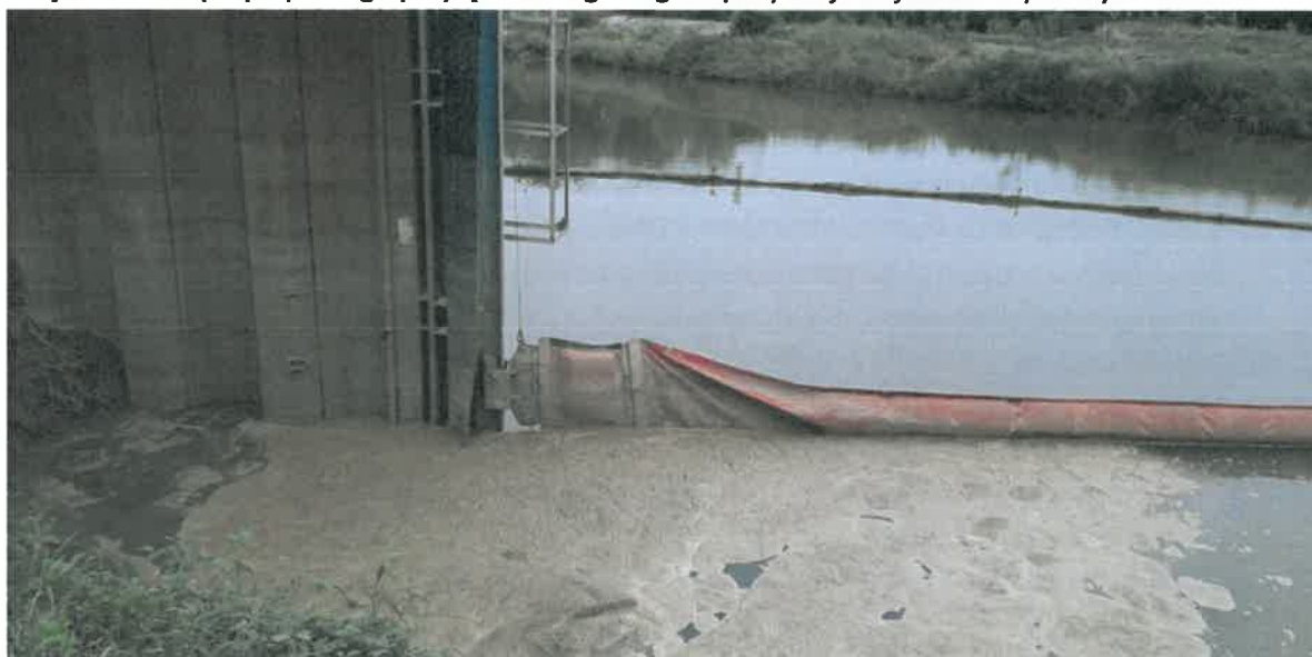
Zdj. 3. Widok przyłącza brzegowego zapory olejowej od strony lądu – do remontu.
