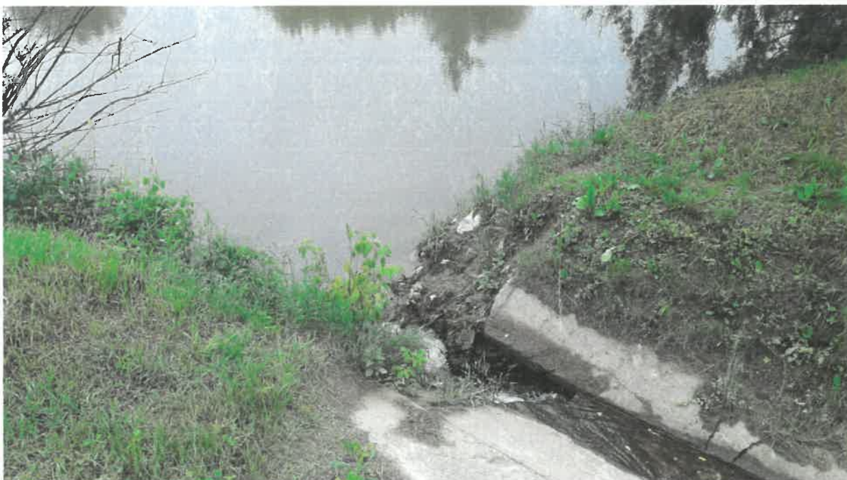
Zdj. 5. Przykład uszkodzenia - włączenie rowu opaskowego do kanału zrzutowego.
