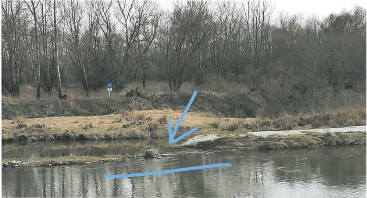
Zdj. 6. Przykład uszkodzenia budowli regulacyjnej – ubytek narzutu kamiennego przed progiem piętrzącym.
