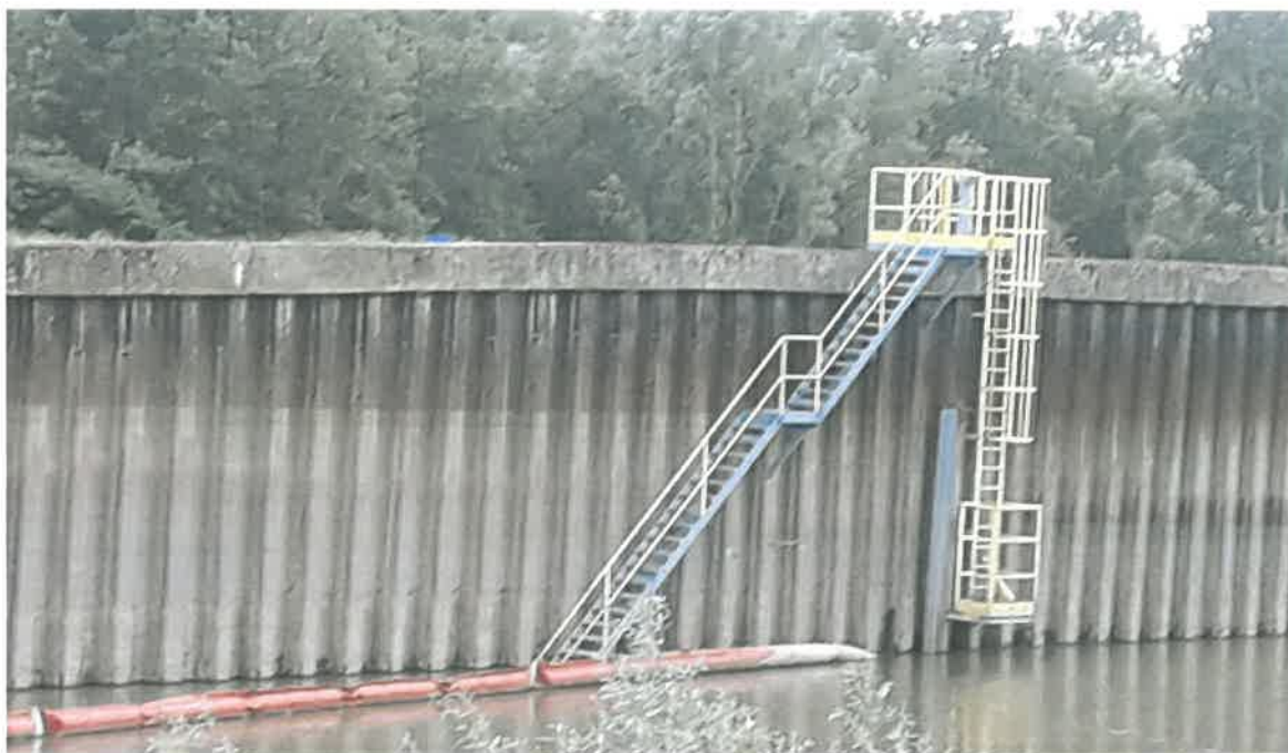
Zdj. 2. Widok przytopionego przyłącza brzegowego zapory olejowej od strony Wisły – do remontu.
