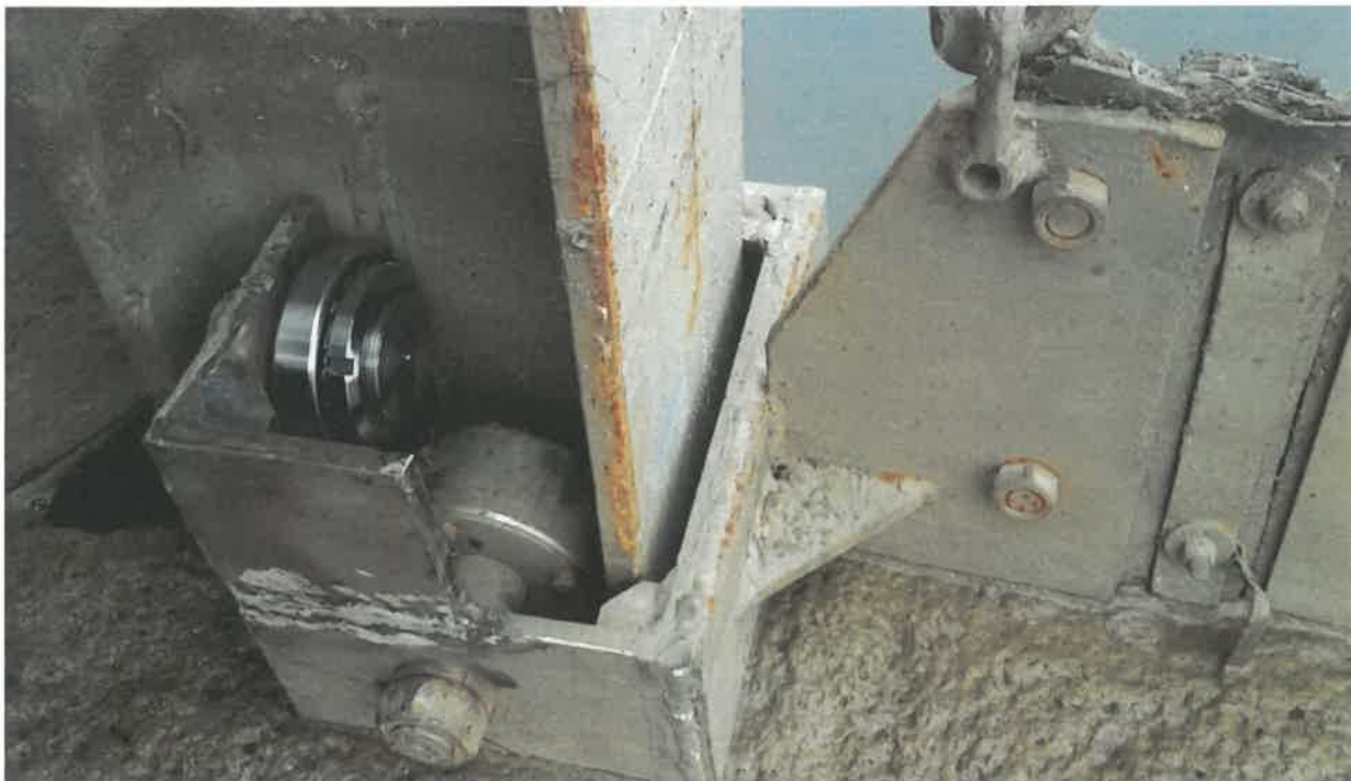
Zdj. 4. Wózek prowadzący przyłącza brzegowego zapory olejowej – do remontu.
